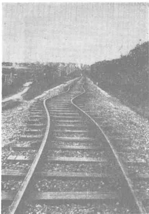
图 17 同前,内埔庄后里驿北约 700 米处铁路轨道波状弯曲。
