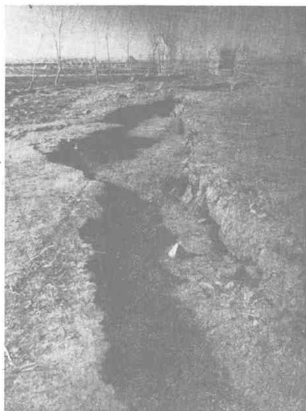
图 24 1966 年 3 月 8 日河北邢台地震。白家寨淦阳河堤裂缝,缝宽 1.75—5 米,中间下陷 3 米。
