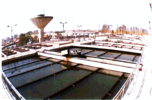
盐城市自来水厂净化池
