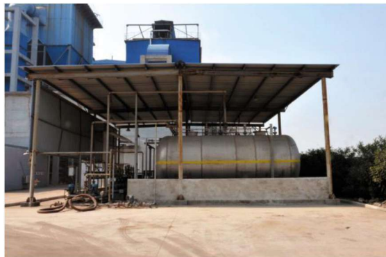
垃圾发电脱硝设备
