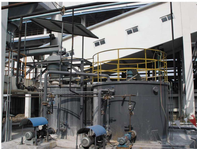
宁波众茂杭州湾热电有限公司脱硫设备图
