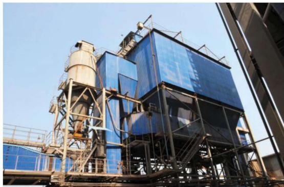
垃圾发电脱硫设备
