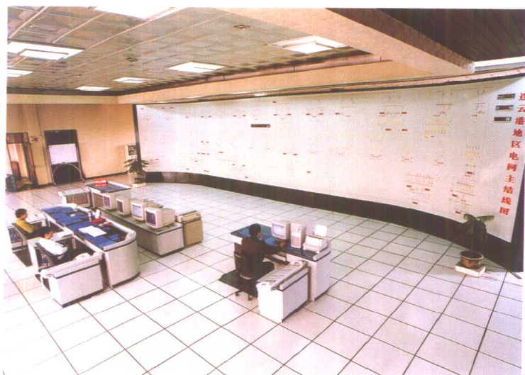
连云港地区电网调度室
