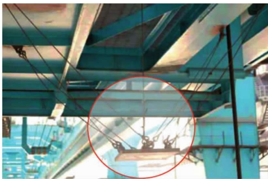
图1-8 小车架下方的重锤限位开关撞块
