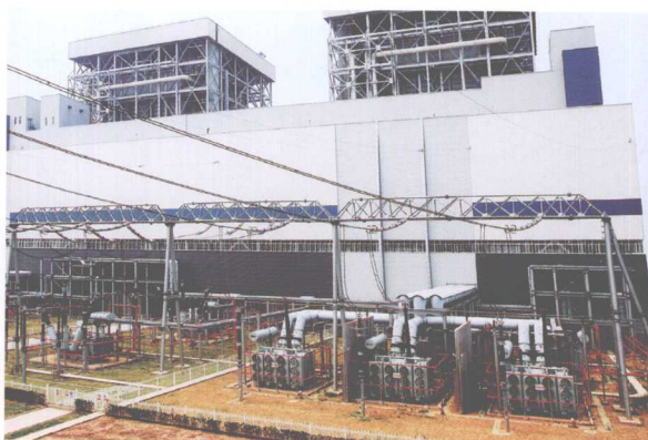
全国发电装机容量突破7亿kW、中国国电集团公司可控装机容量达到6000万kW标志性机组——国电首台百万千瓦机组泰州发电公司1号机组于2007年12月顺利投产。
