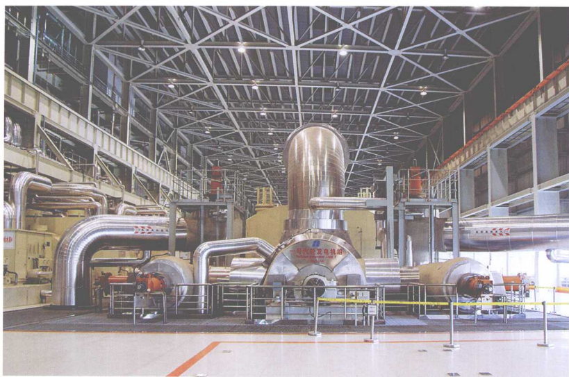
2007年11月24日,华能玉环电厂4台100万kW机组全部投产,图为汽机房。 (中国华能集团公司 提供)
