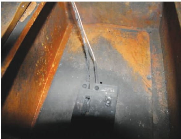
图14 摔落的配电箱
