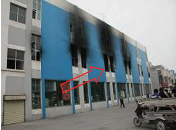
图2 火灾现场北侧二层窗户
