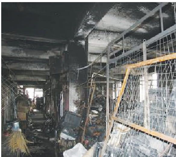
图7 火灾现场二层北侧商户摊位过火照片
