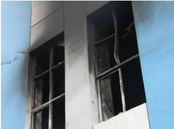
图3 火灾现场北侧二层第二个及第三个窗户
