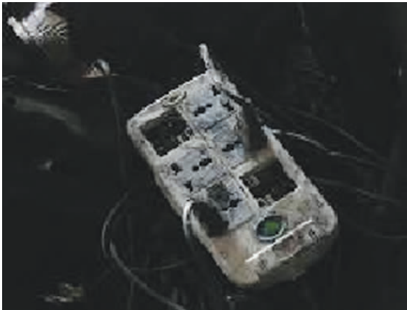
图23 45号商铺东南侧木柜上的插线板
