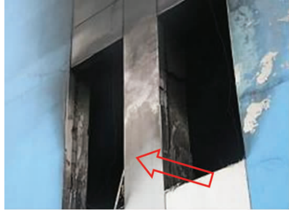
图5 火灾现场北侧二层第四个及第五个窗户
