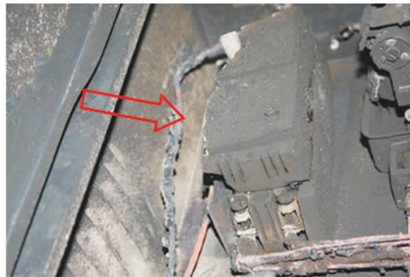
图 13 由东起第二间商铺西侧立柱上的配电箱
