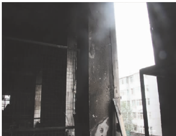
图8 二层北侧窗户受火烧后只剩下窗框残留物
