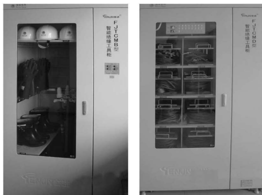
图 1-3 安全用具室安全工具柜及地线柜
