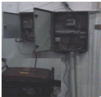
图 1-2-5 无人看管的临时电柜
