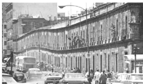
图 0-6 墨西哥城一幢建筑的不均匀沉降
