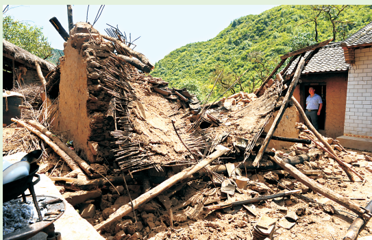
图 1.13 7·22 地震礼县倒塌民房
