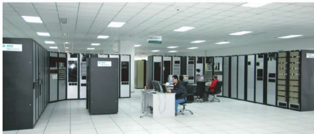
图 1-3 电力系统数模混合仿真实验室
