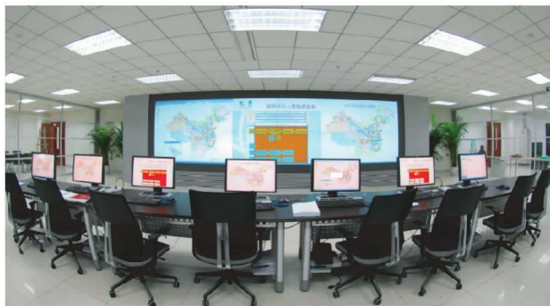
图 1-5 国家电网仿真计算数据中心大厅
