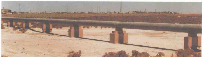
(上图)位于南澳大利亚的皮里港的管道显示经处理及未经处理的管道支柱。工程于1962年完成，而图片摄于1980年发现左方未经处理的支柱有明显的腐蚀情况。
