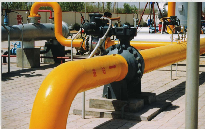
1998年9月，输气管道末站——银川站建成
