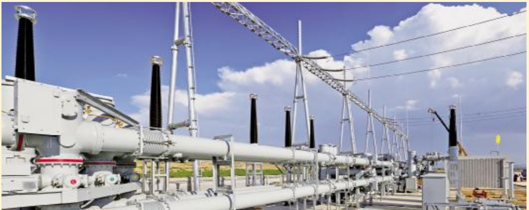
龙源风电同心县马高庄 330kV 输变电工程
