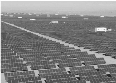
(a) 光伏电站
