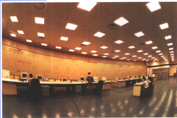
宝钢三期重要的能源工程——宝钢能源控制中心。
