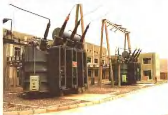
东河清 110kV 变电站
