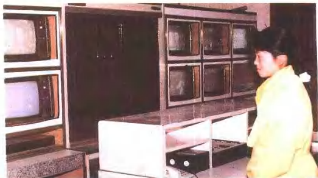
武穴有线电视台机房
