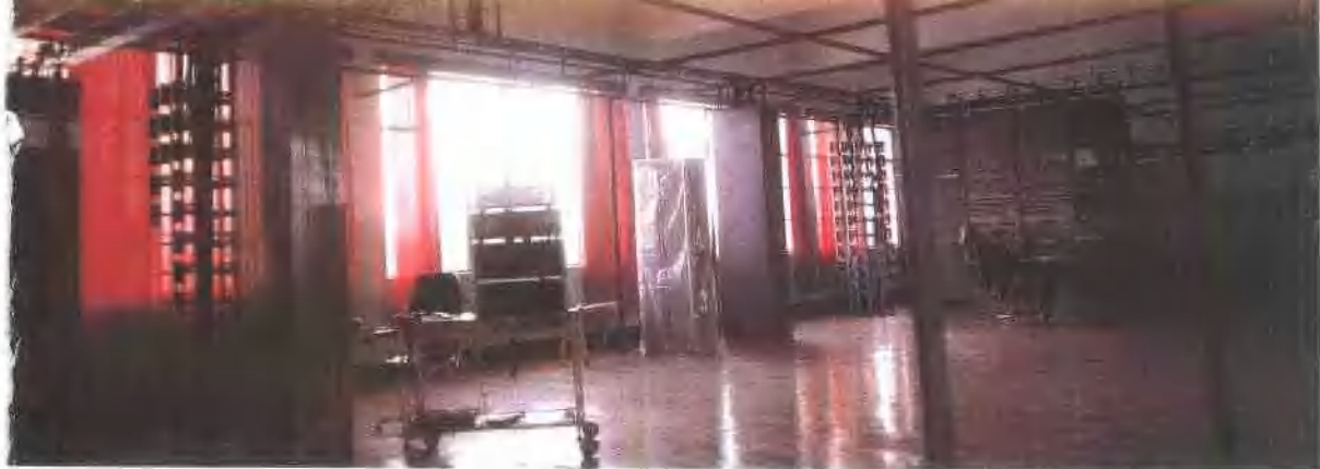
邮电局万门程控电话机房
