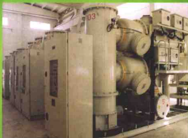
● ZF6-110 型六氟化硫封闭式组合电器
