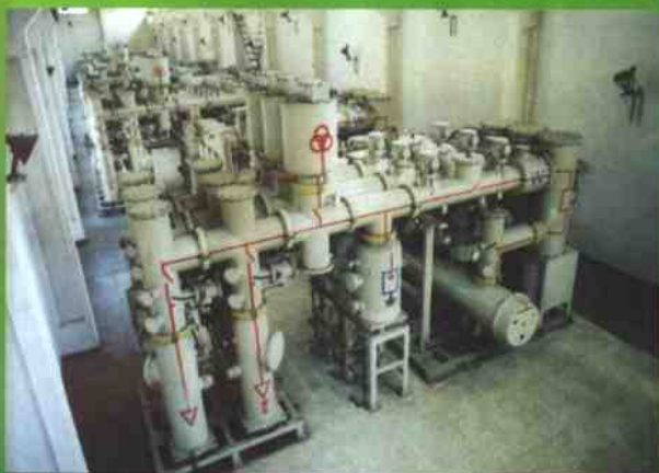
● ZF6-220 型六氟化硫封闭式组合电器
