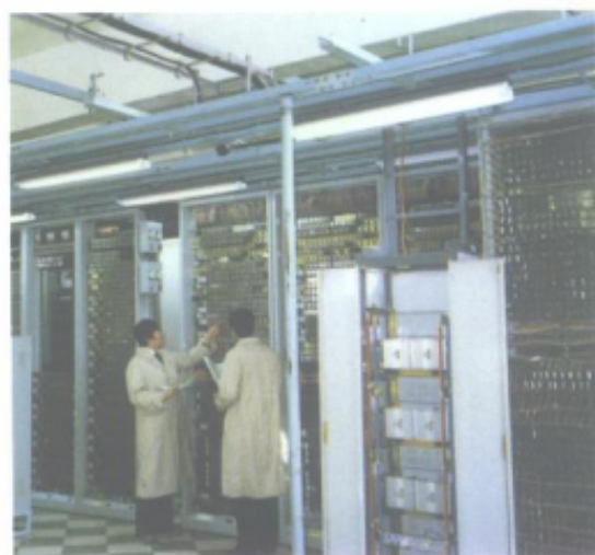
程控交换机房
