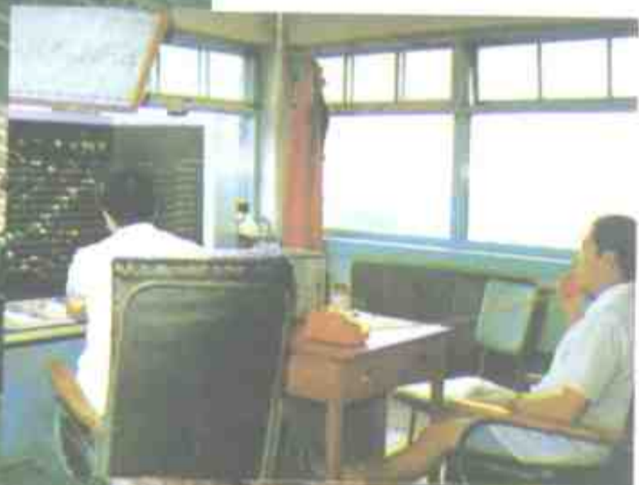
长春站信号楼操纵台
