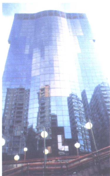
图1-48 产生较严重映像畸变的 玻璃幕墙实例
