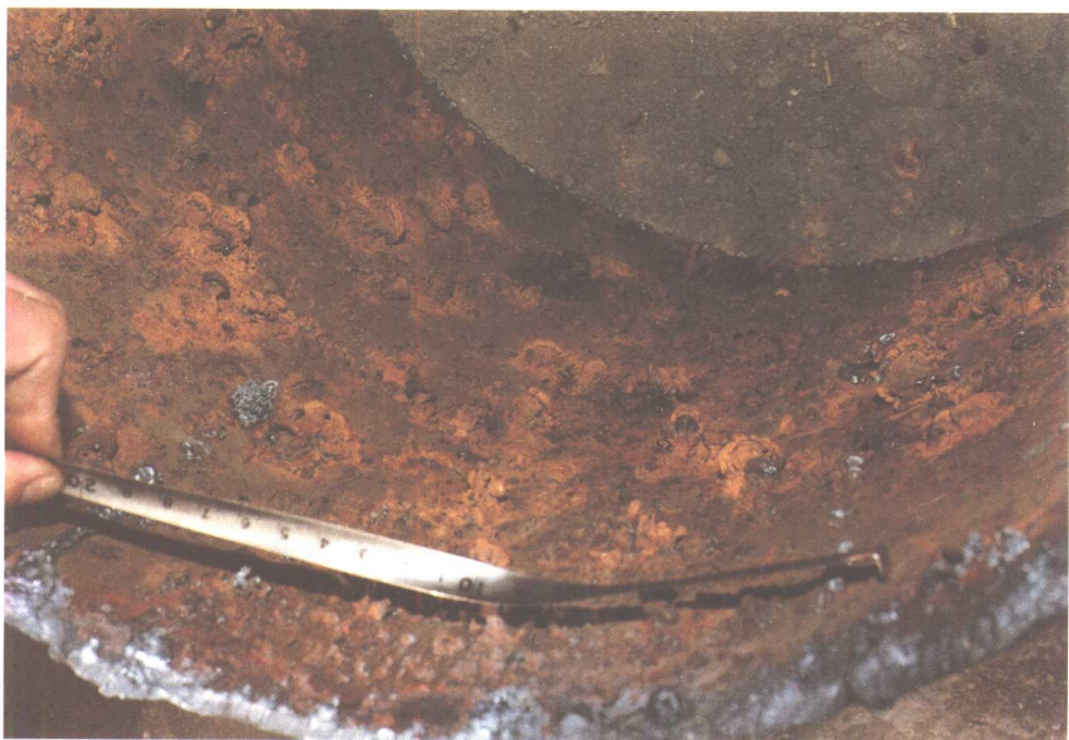
图 10 水平安装的某供热主管内壁底部呈蘑菇状的沉积物
