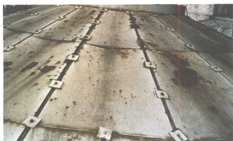
图5 钢板仓顶腐蚀和早期的腐蚀穿孔
