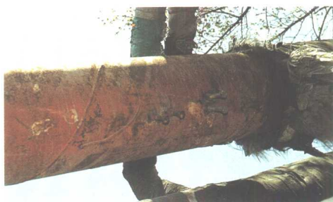
图6 某供热主管底部的早期腐蚀穿孔
