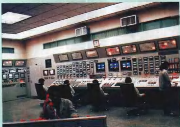
大坝发电厂集控室
