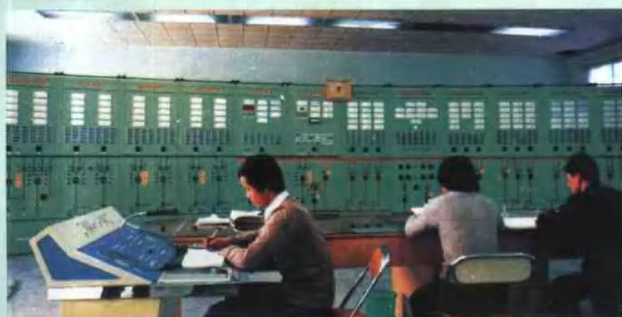
青铜峡变电所值班室
