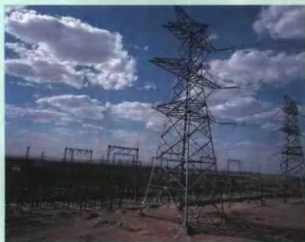
青铜峡变电所
