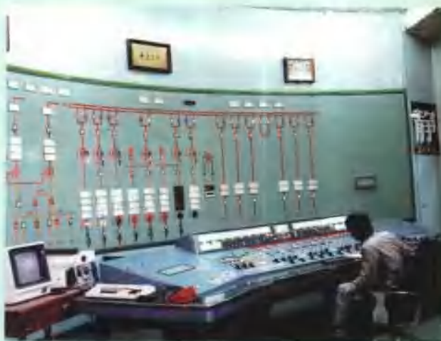
青铜峡水电厂主控制室
