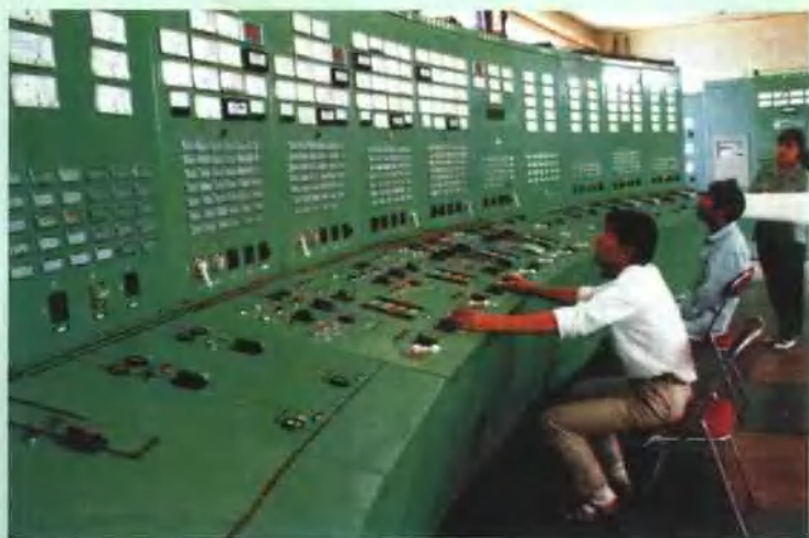
大武口发电厂主控制室
