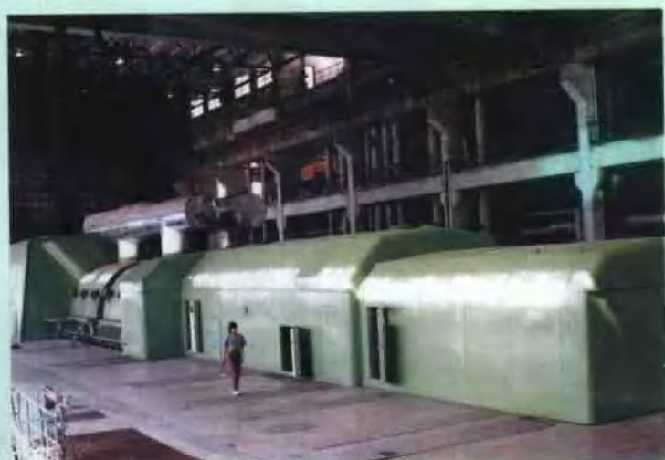
大坝发电厂 30 万千瓦机组
