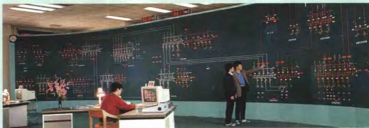
中心调度所主控制室
