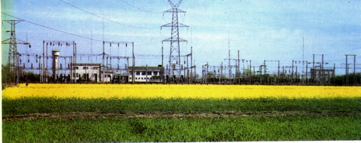
22万伏马坝变电所
