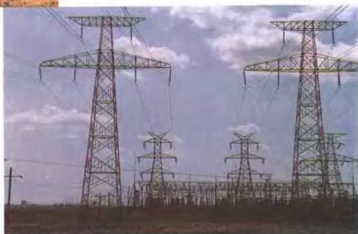
高压输电电网
