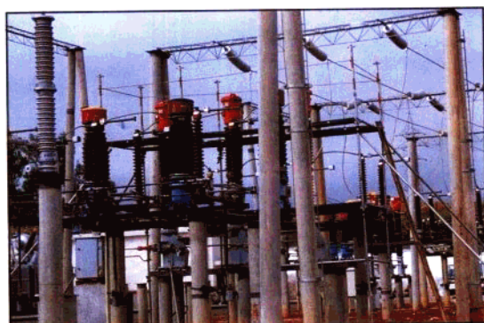
開發區新建 110 千伏變電站
