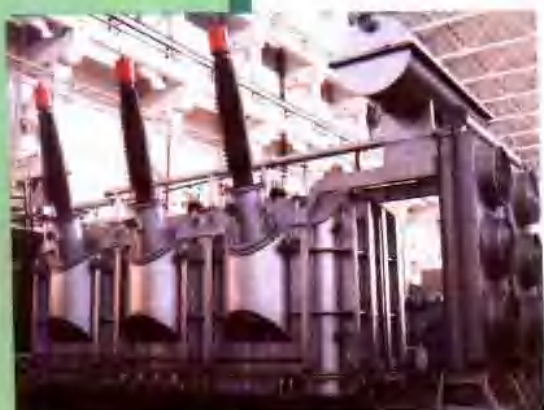
△ SFP 7 -24万伏大型电力变压器
