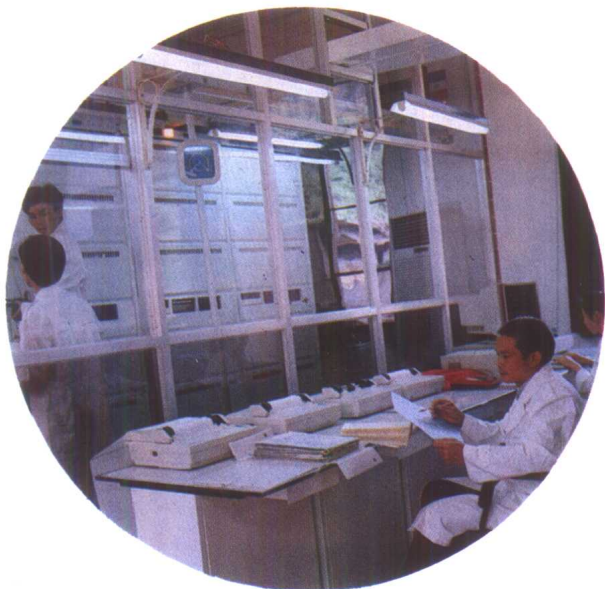
县邮电局程控电话机房
