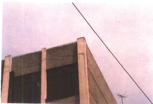
(b) 女儿墙与屋面交接处出现裂缝
