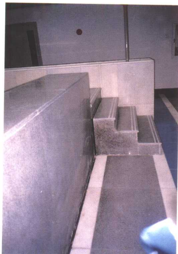
(g) 大面积铺贴石材必需作分仓处理
