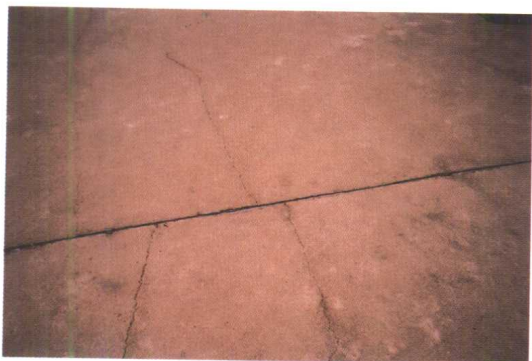
(a) 昼夜温差引起屋面开裂
