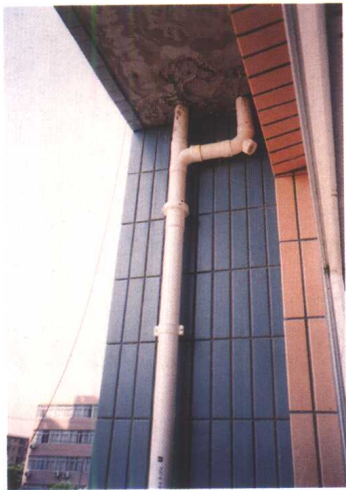
(a) 冷凝水管穿越空调机搁板
