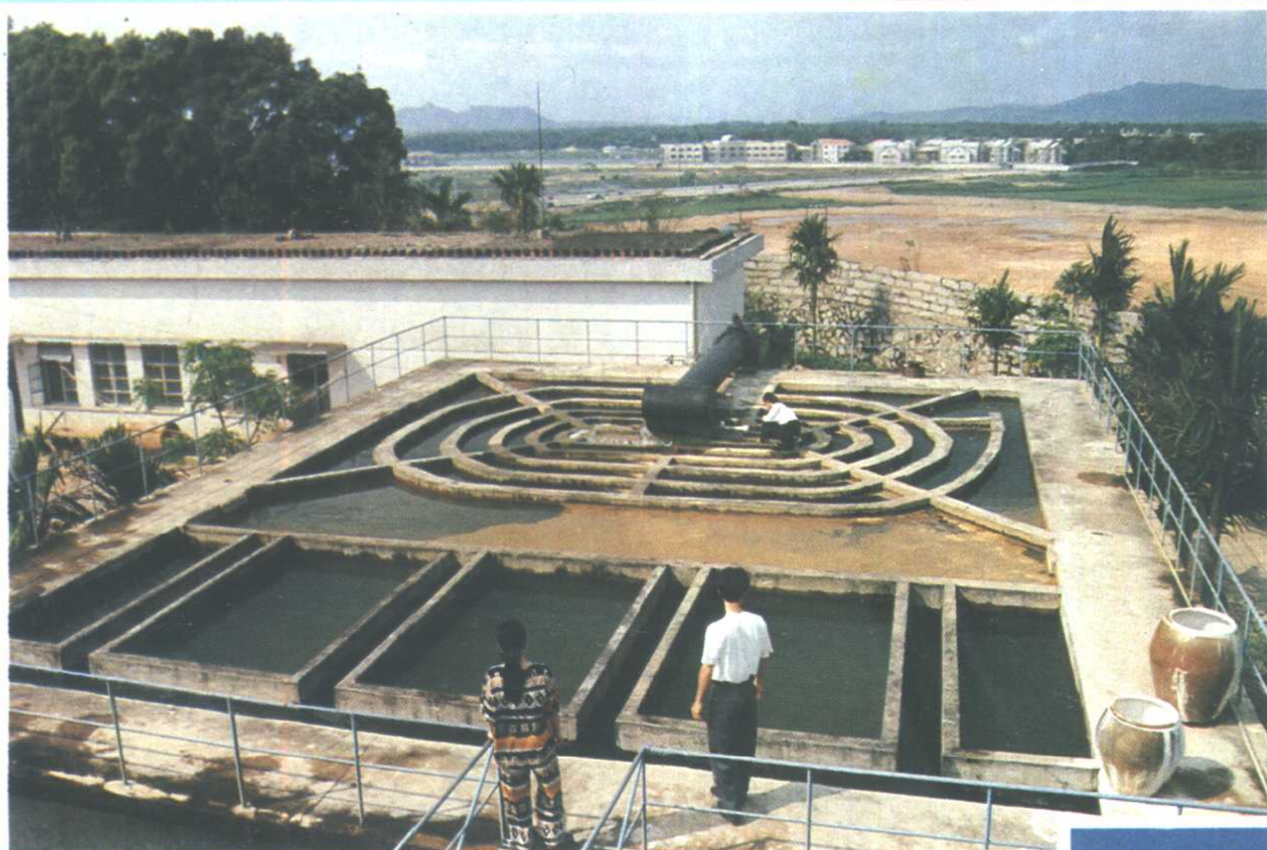
▲ 市自来水公司反应沉淀池
