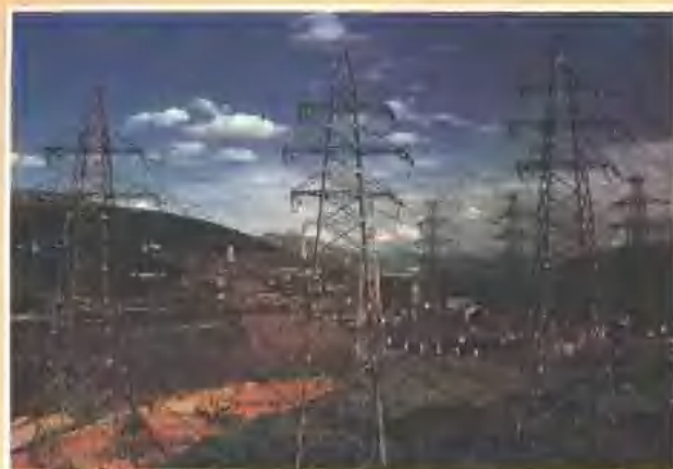
电力高压线铁塔
