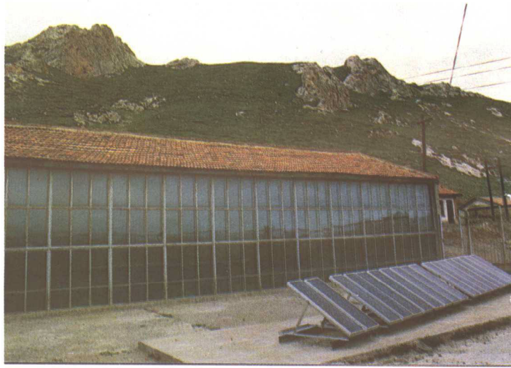
海拔4722米的花石峡长途线路 增音站与太阳能通信电源
