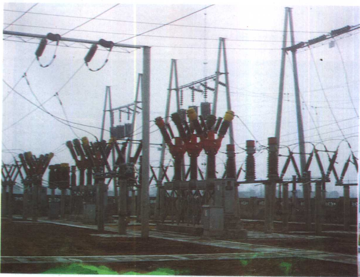
▽ 南门畈 110 千伏变电站
