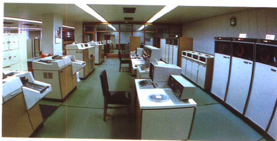
国家气象中心气象 通信枢纽主控室
