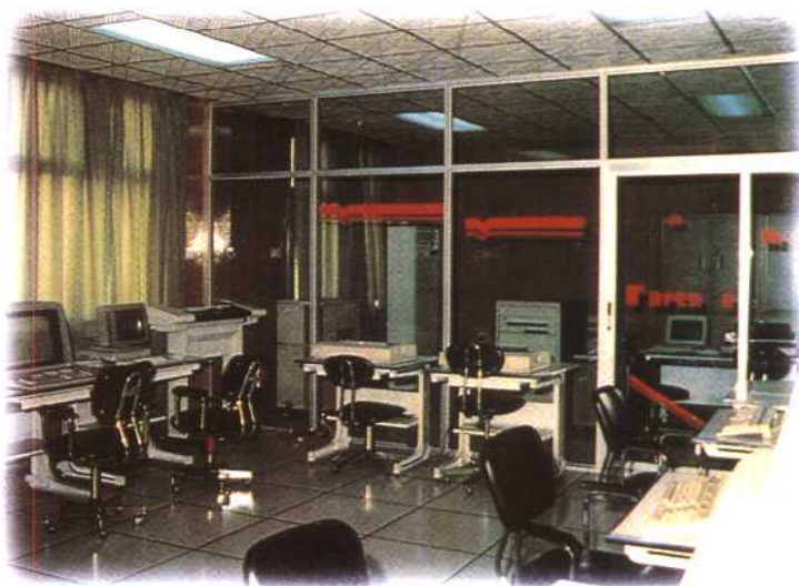
市级微机通信网主控室
