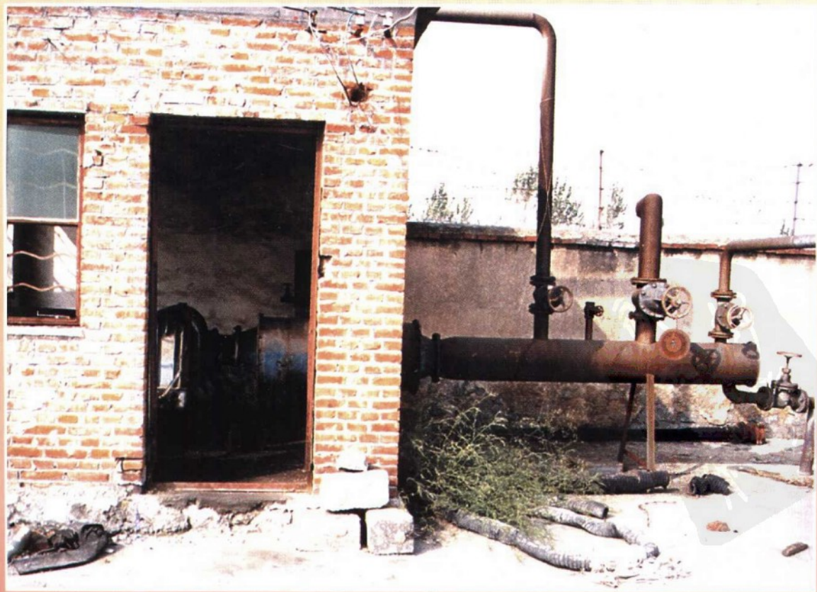
鼓风机和主、支通风管
