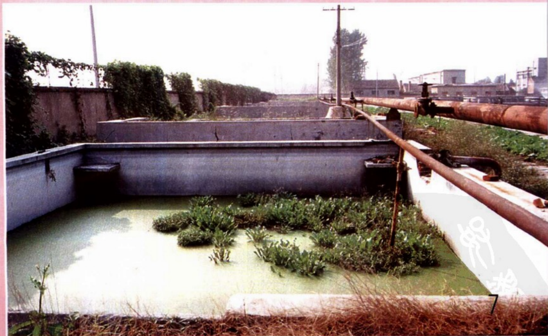
方形鱼池温水进水管和充气支管
