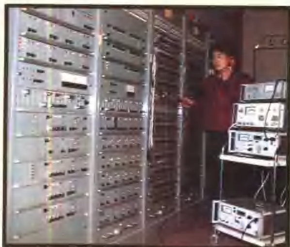
濮阳960路微波通信机房 刘援朝摄
