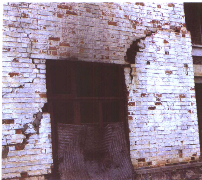
变性土体胀缩引起开裂的建筑物 广西上思 (龚子同)
