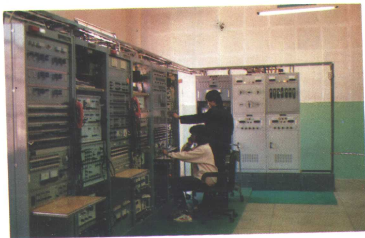
县邮电局机务室
