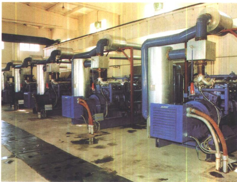
图7 大型污水处理厂沼气发电机房
