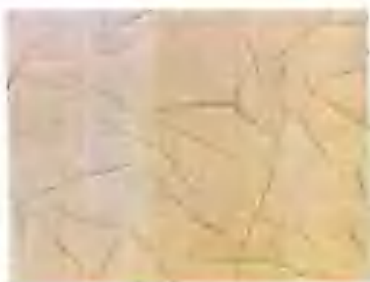
26. 裂开，龟裂 Cracking
