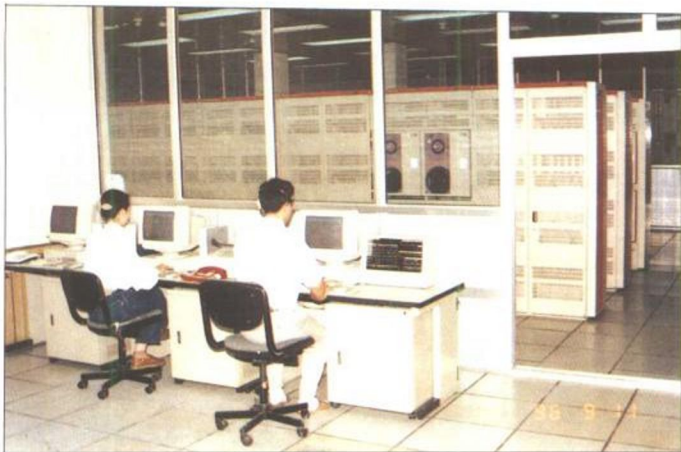
山海关区邮电局程控机房
