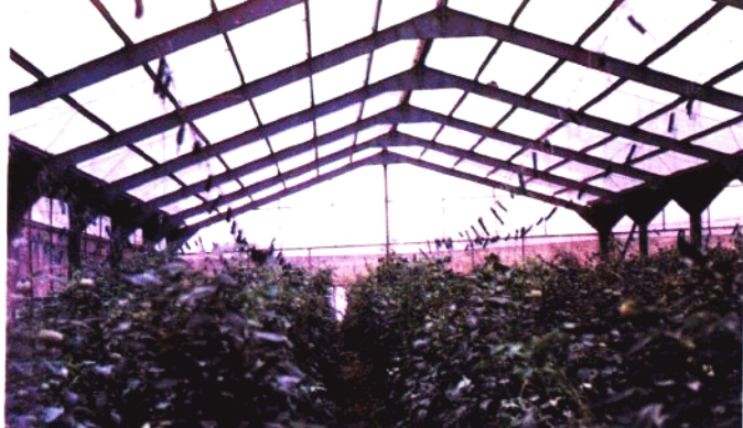
大型钢骨 架温室
