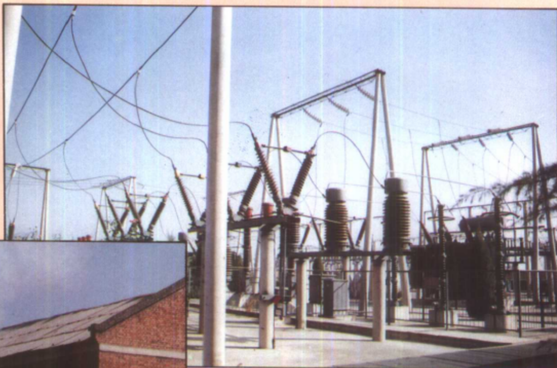
封丘 110kv 变电站
