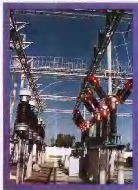
农行贷款建设的110千伏变电站
