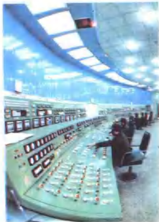
发电厂集中控制室 (许先行摄)
