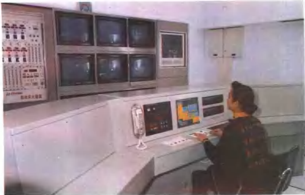
档案馆监控室
