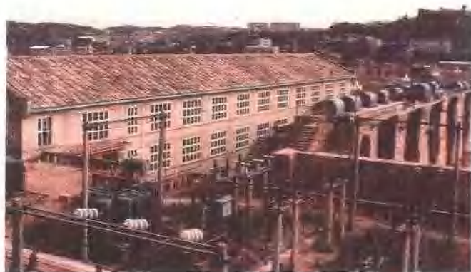
潼南三块石水电站室外配电装置
