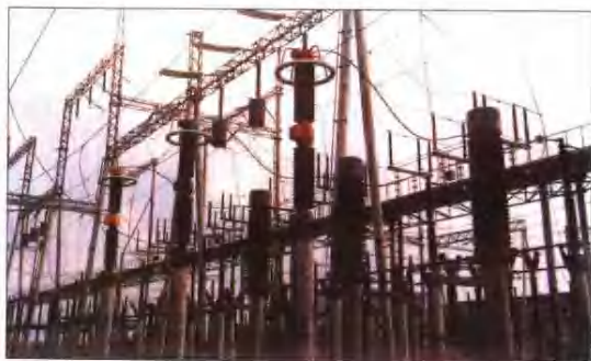
220KV 昆山变电站
